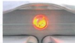
点滅(電源電圧異常)
